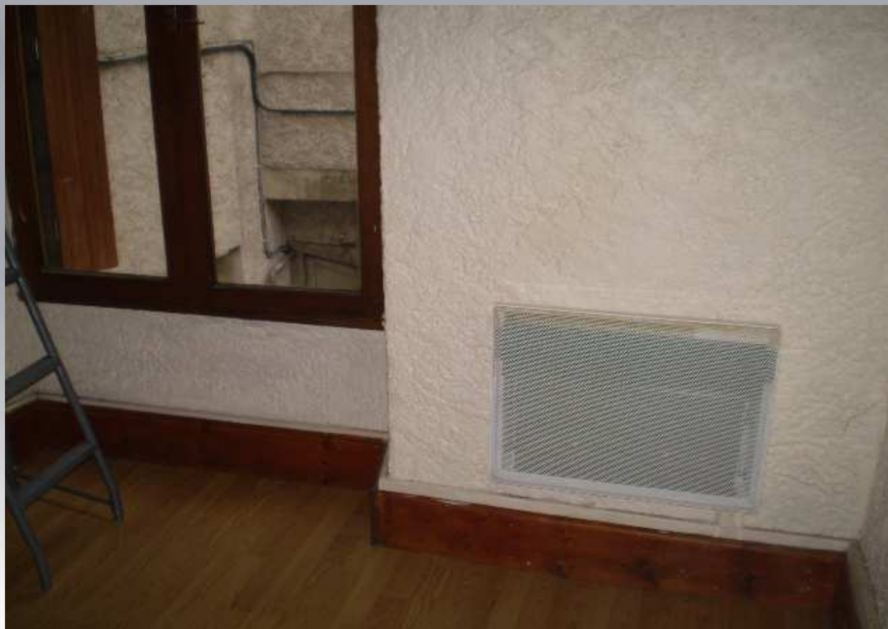
Fenêtre : absence de garde corps et de ventilation
