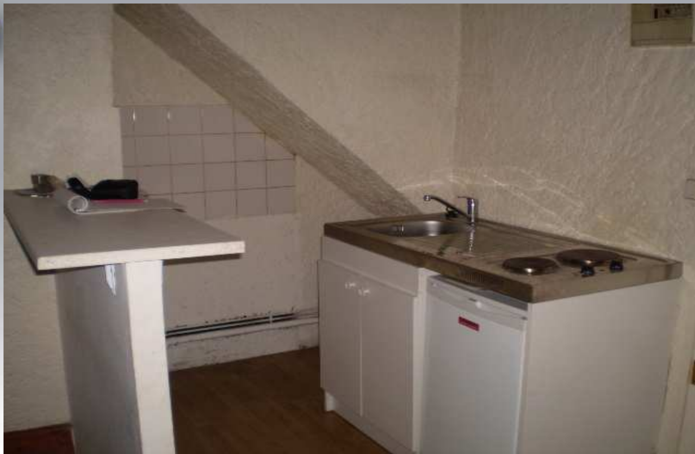
Cuisine : absence de ventilation
