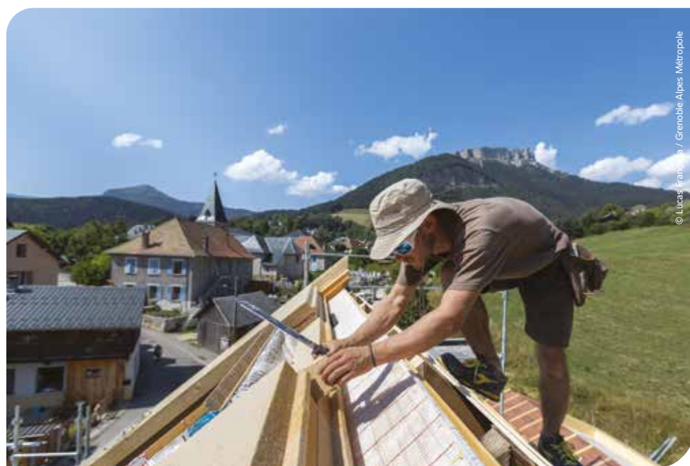
FORTE DU SUCCÈS DE SA PREMIÈRE CAMPAGNE D'ISOLATION THERMIQUE DES COPROPRIÉTÉS, GRENOBLE-ALPES MÉTROPOLÉ POURSUIT L'OPÉRATION MUR/MUR AVEC DES OBJECTIFS PLUS AMBITIEUX.
